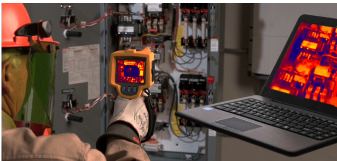
Рисунок 20. Пример проведения тепловизионного контроля электрошкафа
